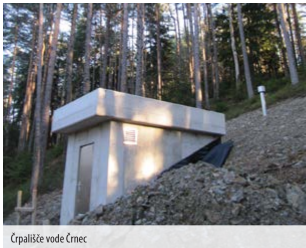
Črpališče vode Črnc
